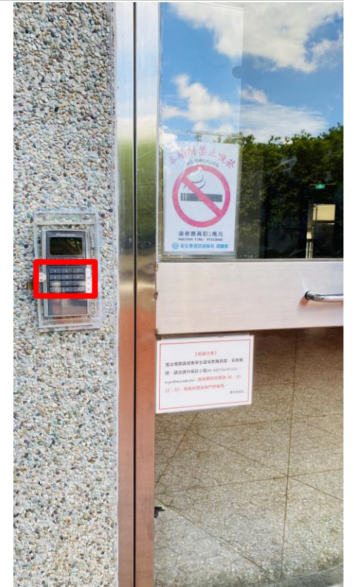
據德樓門禁系統位於面對據德樓左側大門旁
